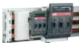
Sistema de barramento
